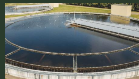
9. Тенгиз WTP Комплекс по очистке воды.
